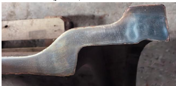
Рис. 4 Состояние стенки трубы Ду 800 мм, представленное на торцевом срезе.
