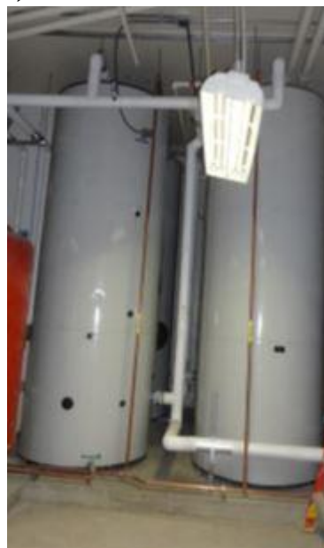
Рис. 4. Резервуары для горячей воды
