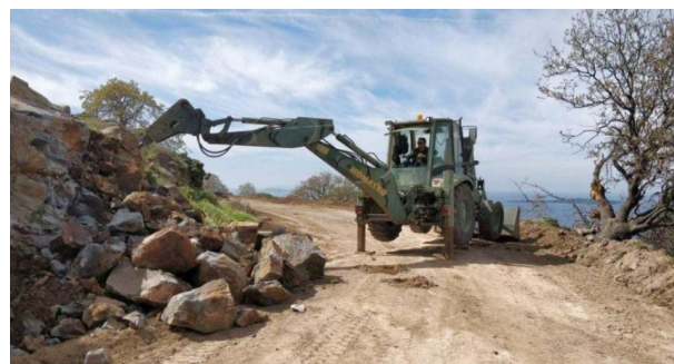
Рисунок 5. Дробление горных пород вдоль полотна дороги
