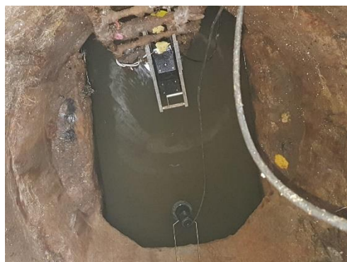
Рис. 2. Пример установки узла учета расходов сточных вод в канализационном колодце
