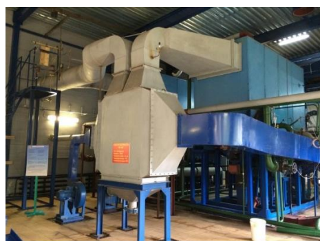
Общий вид отделения котлов высокотемпературного кипящего слоя КВП 1.74 ВТКС и КВП 1.74 ВТКС
