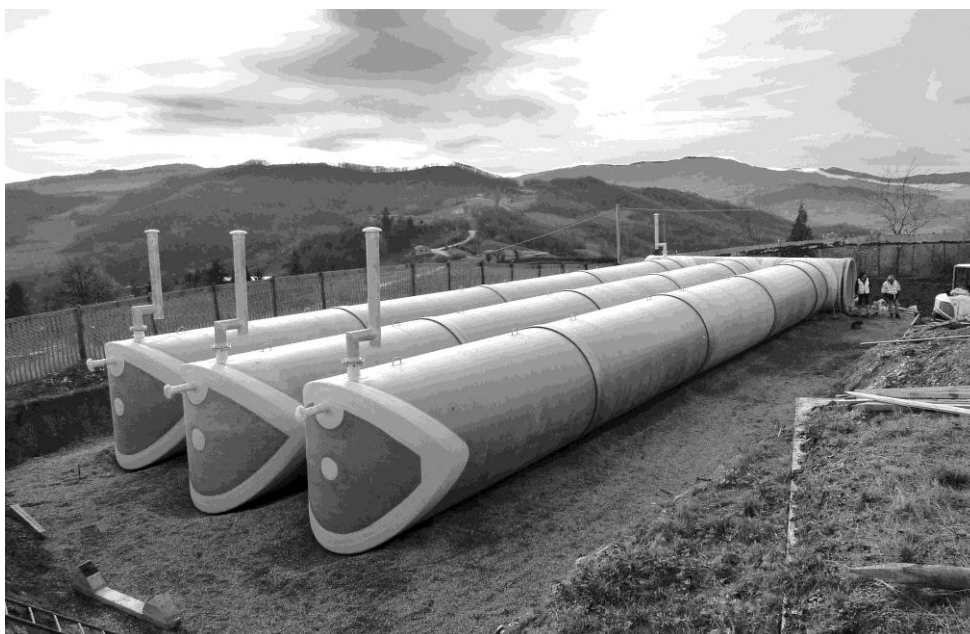
Рис. 4. Внешний вид блок-модуля резервуаров на трассе магистрального водовода
