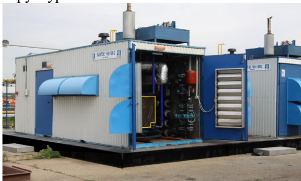
Рис.4. Комбинированная энергоустановка на базе ДВС
