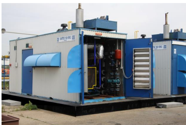
Рис.3. Комбинированная энергоустановка на базе ДВС
