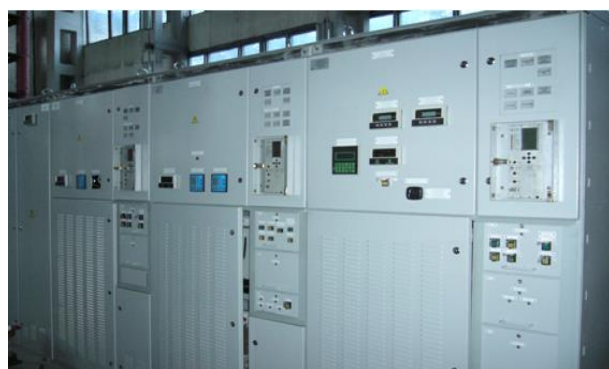
Рис.1. Сейсмостойкое низковольтное распределительное устройство для объектов специального назначения
