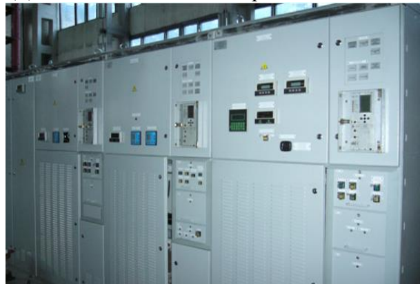
Рис.1. Сейсмостойкое низковольтное распределительное устройство для объектов специального назначения
