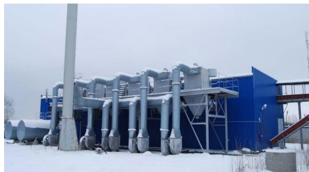
Рис.5. Общий вид котельной с котлами КВП 1.74 ВТКС п. Горская, Лен. обл.
